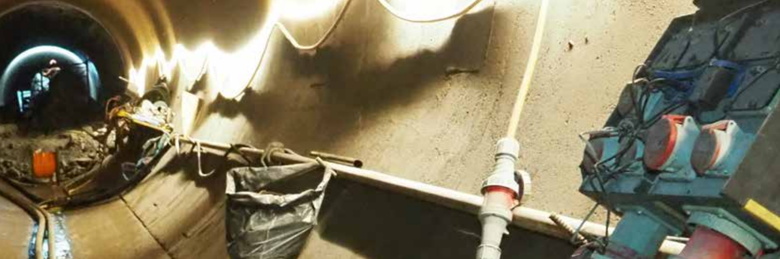
Sofortmassnahmen Stollen Punt dal Gall - Ova Spin, im Jahr 2024.
