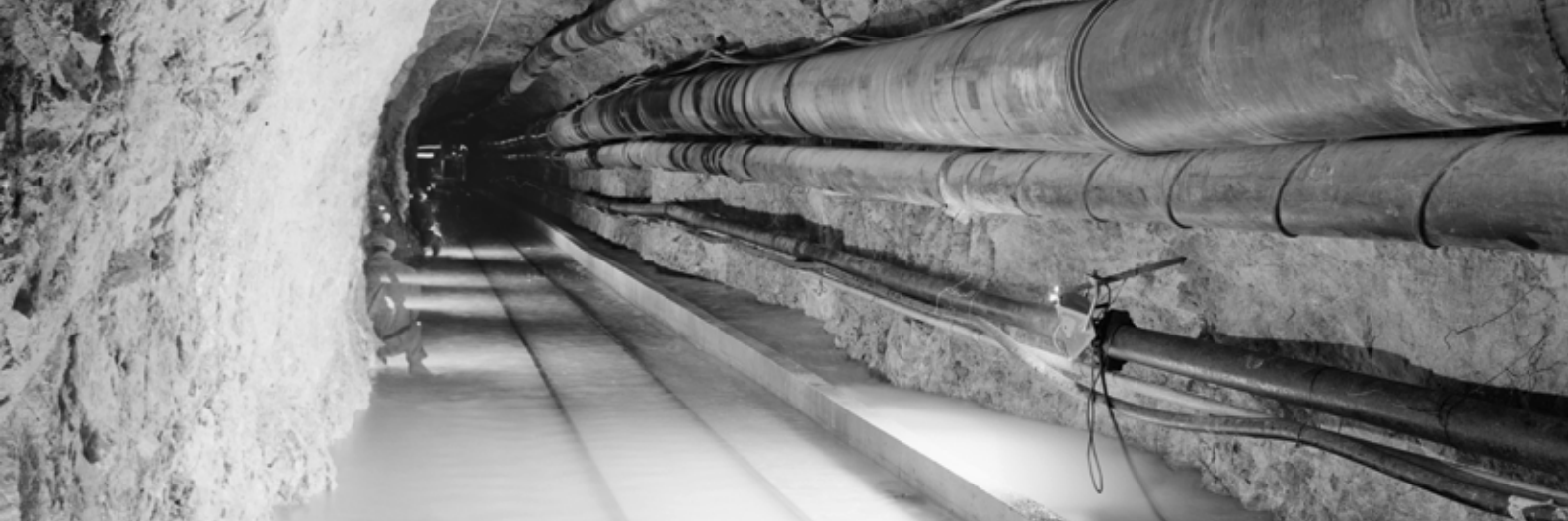
Via da S-charl, Druckstollen, Wassereinbruch, im Jahr 1965.
